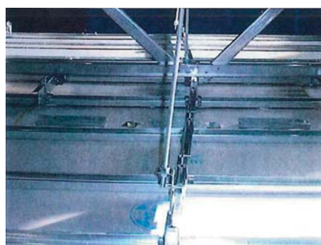
写真-3 破壊状況:野縁受けの曲げ変形
