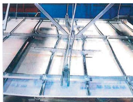
写真-4 破壊状況:補強野縁受けの曲げ変形 野縁の曲げ変形
