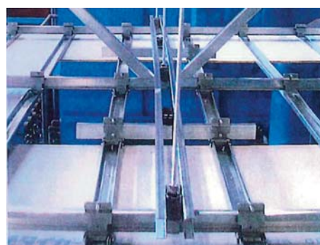
写真-4 破壊状況:せっこうボードの脱落 補強縁受けの曲げ変形 野縁の局部変形
